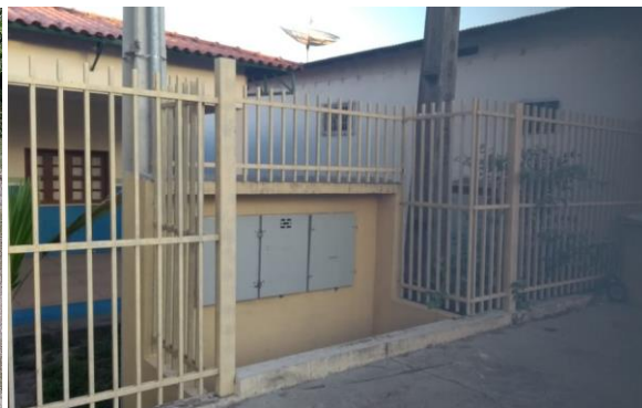
SUBESTAÇÃO DE MONTE ALEGRE
