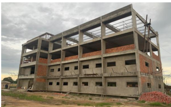
BLOCO PADRÃO DE ITAITUBA
